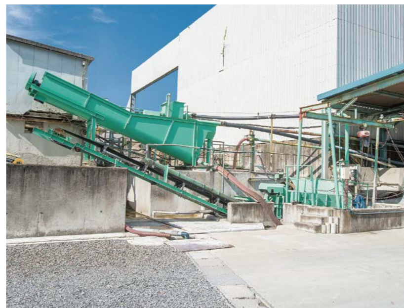
濁水処理プラント
